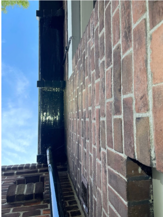
Figuur 6 Geen ruimte tussen regenpijp, dakgoot en gevel
