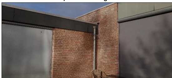
Foto 5: Muur met open stootvoegen
