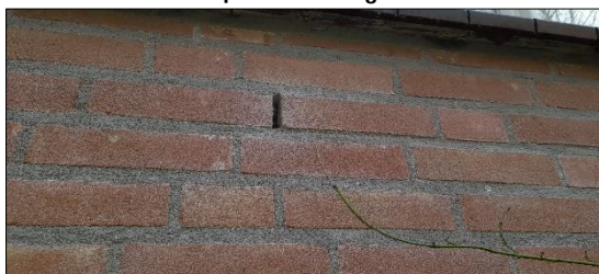
Foto 6: Muur met open stootvoegen
